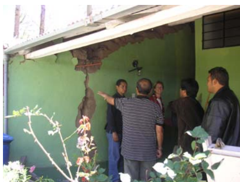
Algunas viviendas tras el terremoto en Tantara
